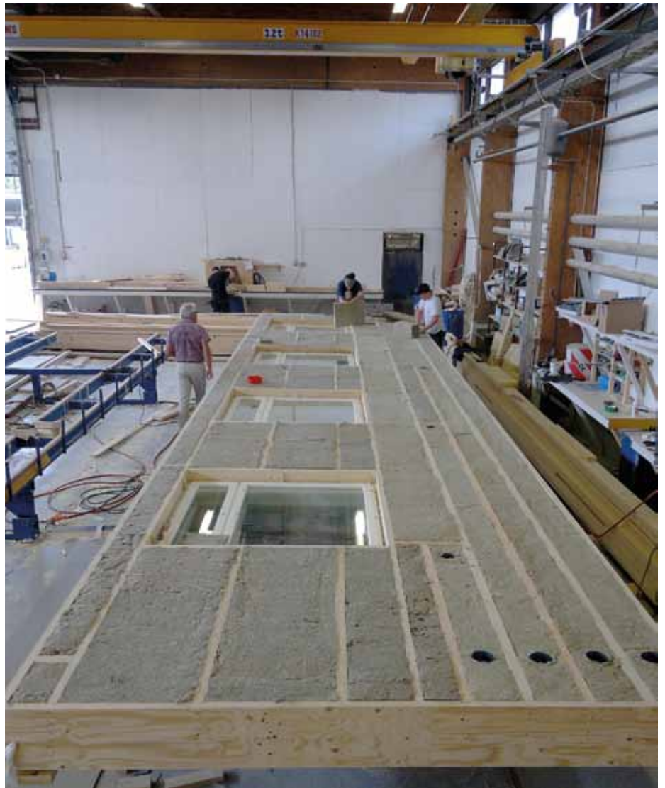
Suurelementtien runko on rakennettu kertopuusta, johon on kiinnitetty elementin sisäpinnaksi 9 mm:n viisikerroksinen havuvaneri. Vanha eristekerros korvataan Parocin eristevillalla.
